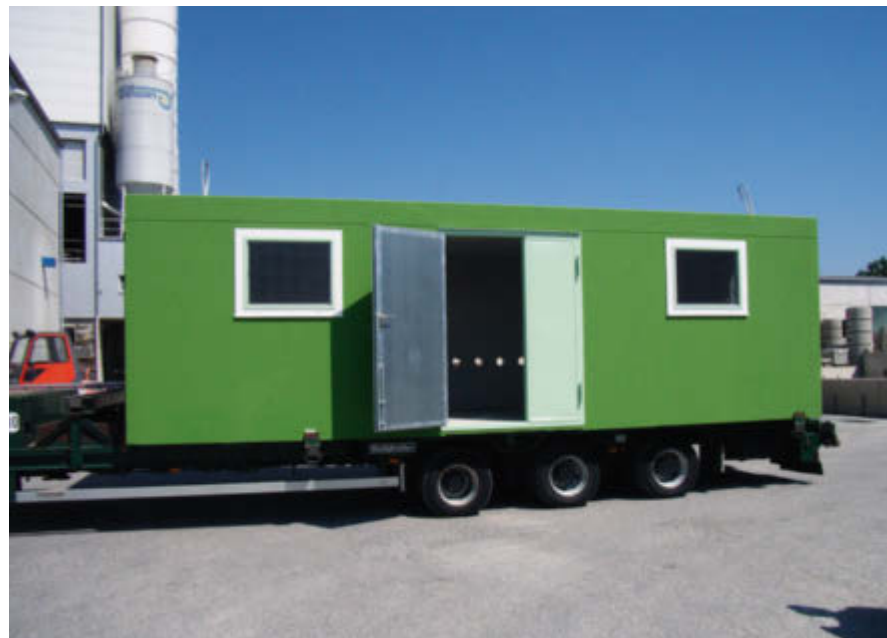
Gassammelstation für Deponien
