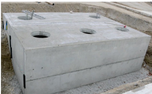
Rigolenanschlussschacht für MAN in München
