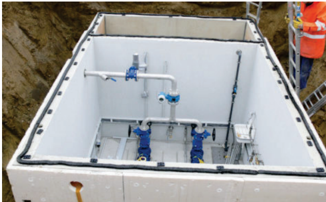
Abwasserpumpschacht in Bruckmühl
