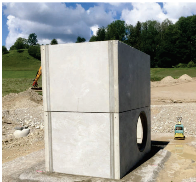
Regelbauwerk mit Spindelschieber, Rohranschlussmuffen und Gerinne
