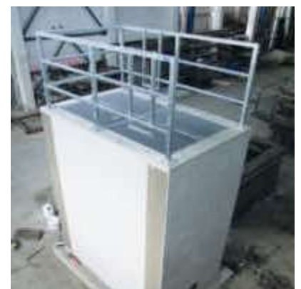
mit verzinktem, 3-seitigem Absturzgeländer
