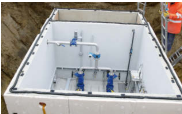
Abwasserpumpschacht in Bruckmühl
