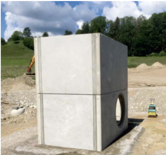
Regelbauwerk mit Spindelschieber, Rohranschlussmuffen und Gerinne
